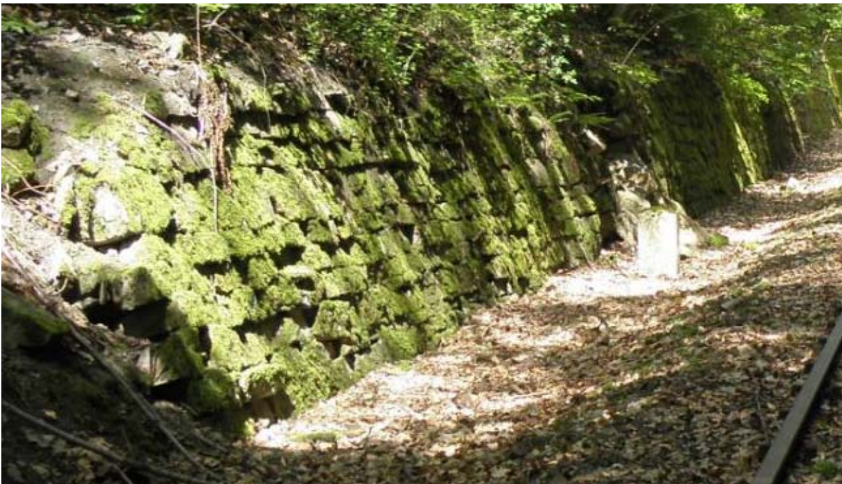
Abbildung 6: Die Stützmauer bei km 10,1 vor der Instandsetzung durch die NTB
